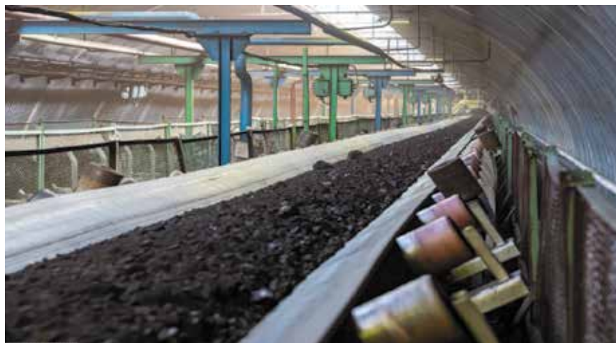
Рисунок 2. Ленточный конвейер на Красноярской электростанции. Автор: Александр Попов, Источник: https://russos.livejournal.com/1487649.html
